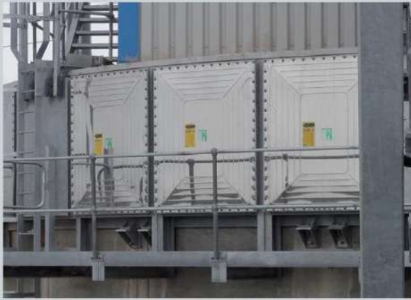
Discos de ruptura instalados en almacenamiento de tránsito
