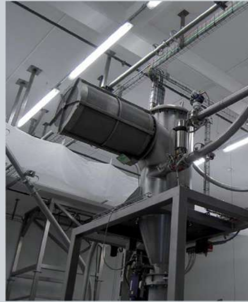
Q-ror es lo más apropiada para la protección de sistemas de transporte neumáticos ya que resiste fluctuación de la presión
